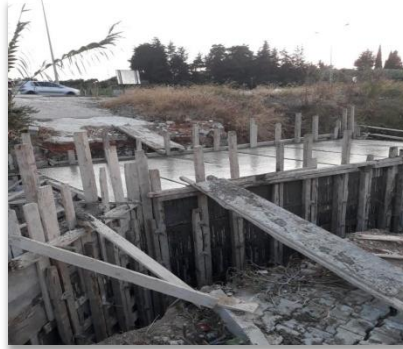
Bostancık Mahallesi (Esenbulak - Çevre Yolu arası) Kutu Menfez
